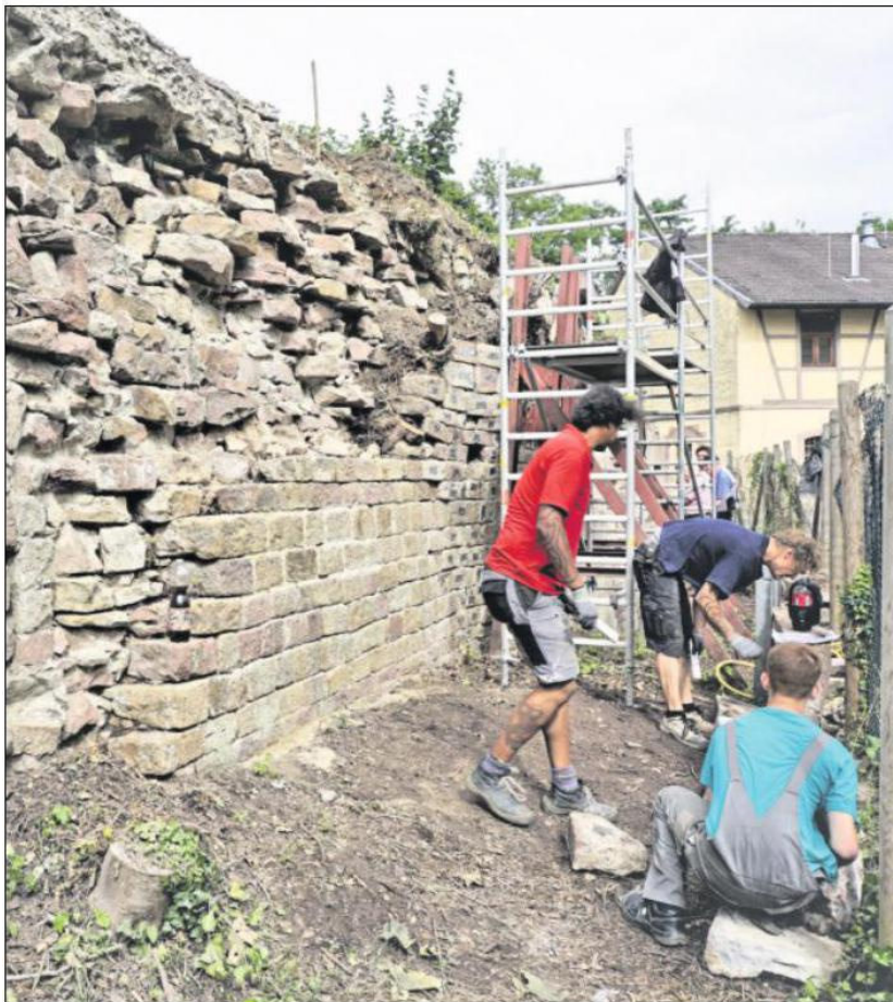
MÖRTELMUSTER: An der äußeren Mauer der linken Flanke wurden dreierlei Fugenmuster angelegt, die den historischen Farben möglichst nahe kommen sollen. Foto: Collet
